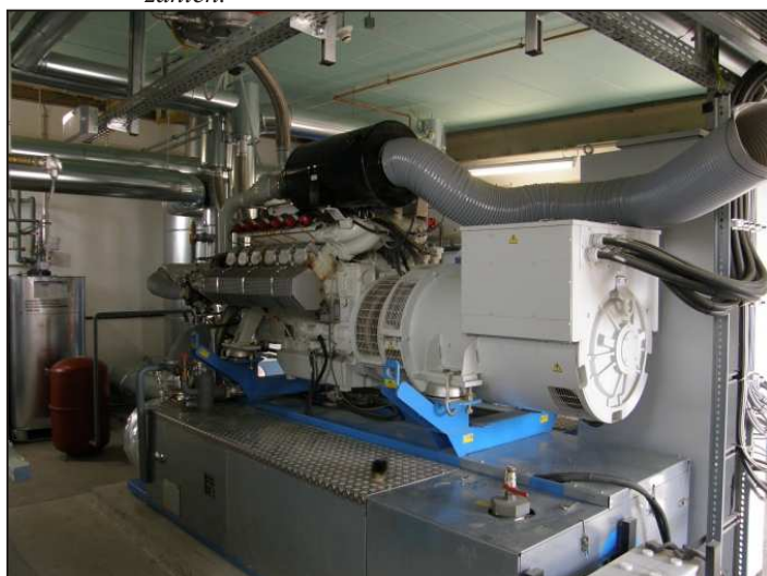
Das Blockheizkraftwerk als Herzstück der Biogasanlage. Hier wird aus Biogas Strom hergestellt und Abwärme gewonnen.
